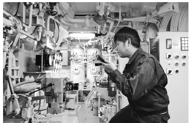
機関室にてシステムの運用試験中
